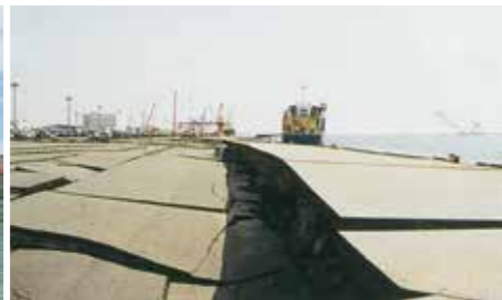
地面に亀裂が生じている岸壁
