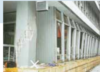
神戸外郵出張所(神戸港郵便局) 倒壊寸前のため立入禁止となった
