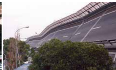
阪神高速道路の倒壊(写真提供:神戸市)
